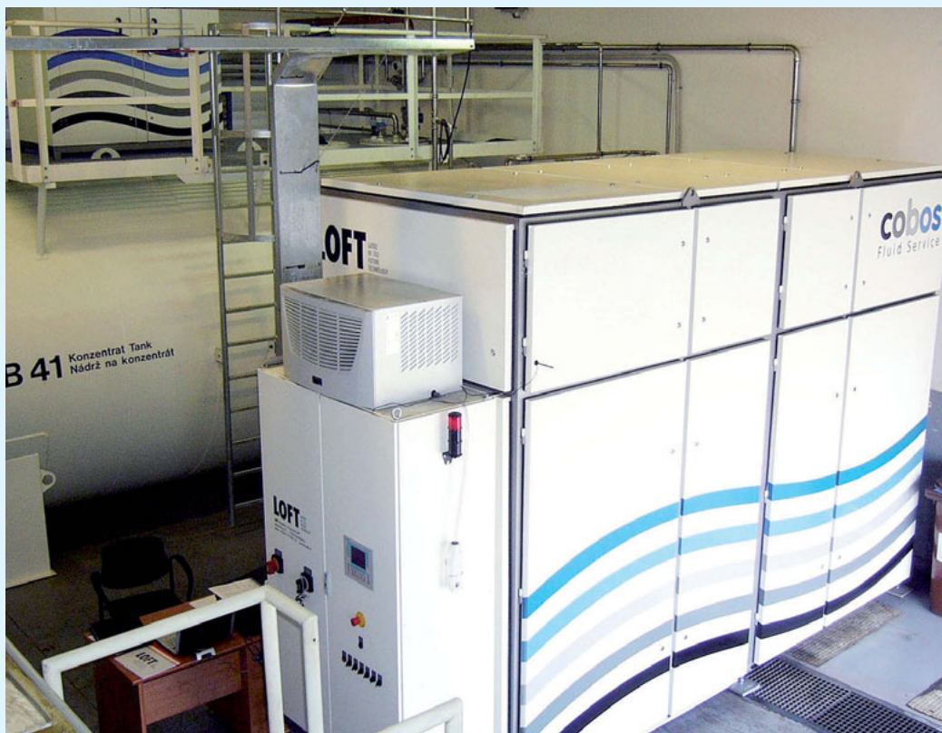
BEHANDLUNGSANLAGE FÜR PROZESSWASSER: Hier ist sie in die Produktionshalle integriert
